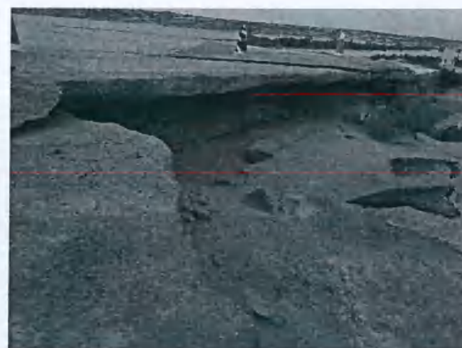
过水路面较短，路面掏空
