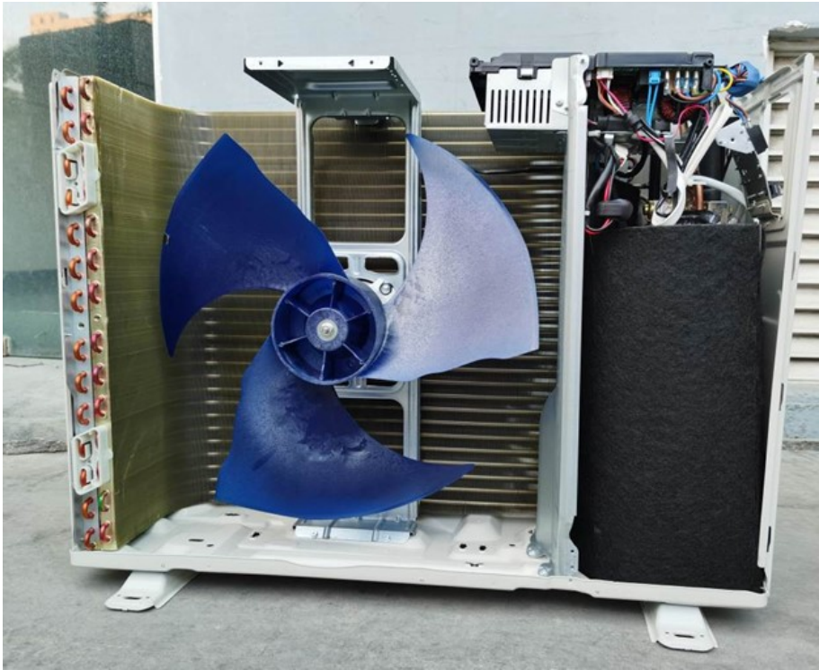
室外机开盖照
